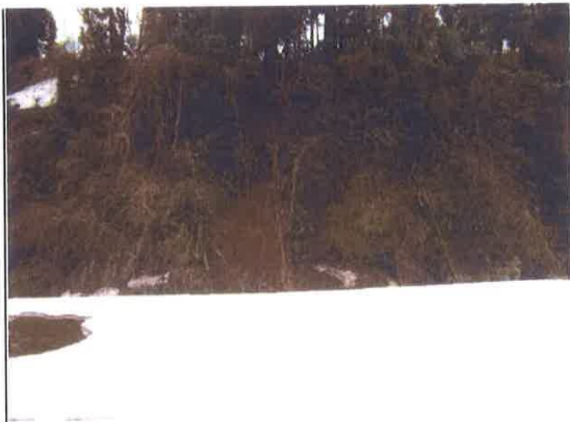
要望事項② 崩落箇所全景
