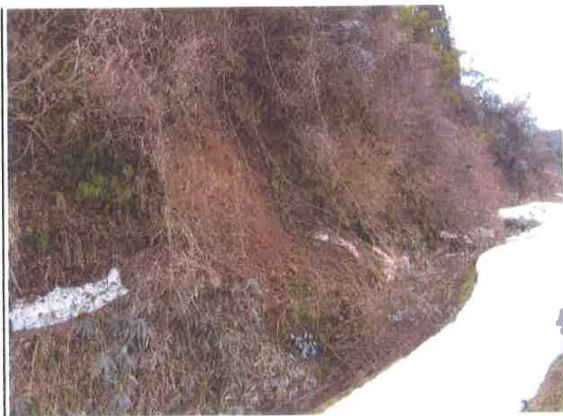
要望事項② 崩落箇所(下流側)
