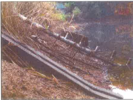
斜樋の老朽化
