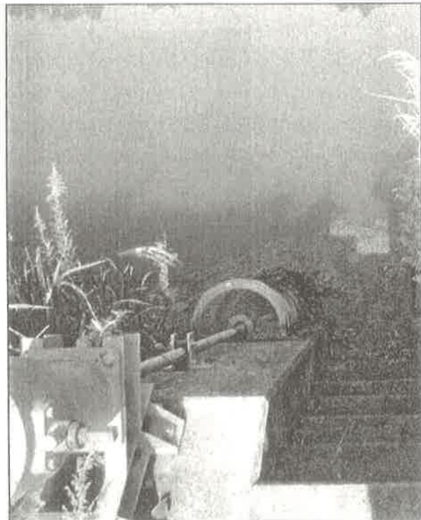
新設のパイプライン用の斜樋には底樋が無い
