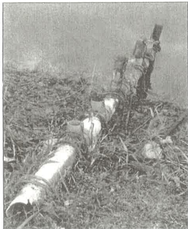
老朽化した斜樋・底樋
