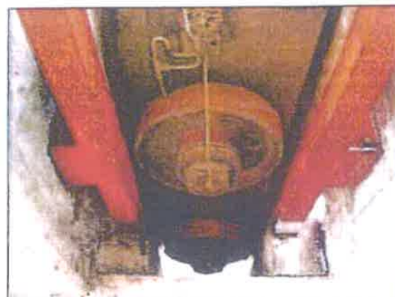
ローラーの腐食（2）
