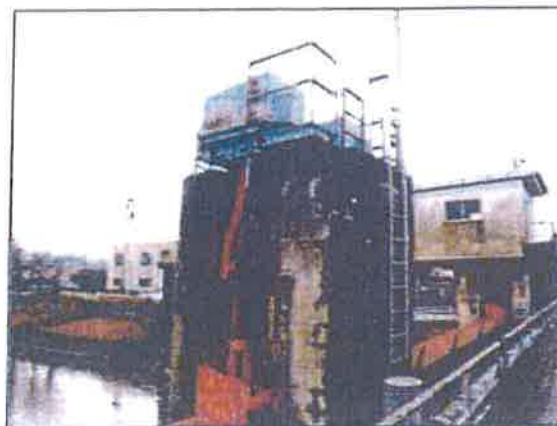
巻上げ機の腐食
