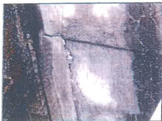
コンクリートのひび割れ
