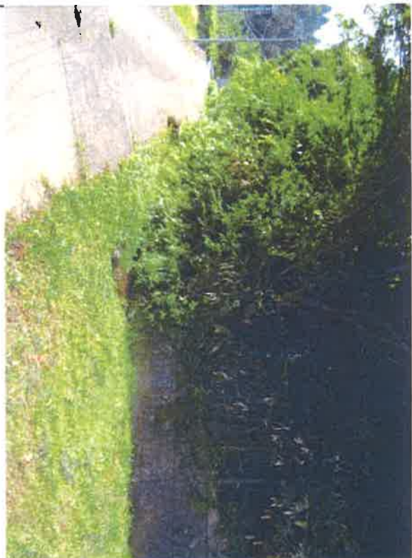
要望事項一⑥ 隣接の防災工事の構造物と 落石箇所
