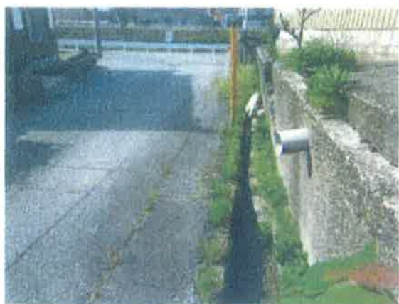
1.側溝破損による狹隘
