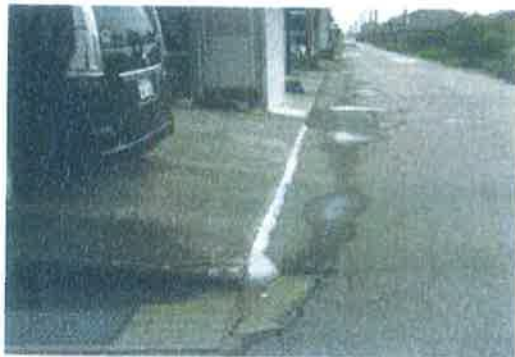
1) 宅前より窪9号線海側を見る。 側溝無いので水溜りができる。
