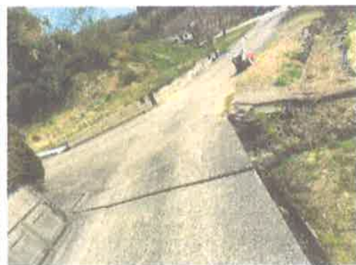
㊩寺田道法面が侵食
