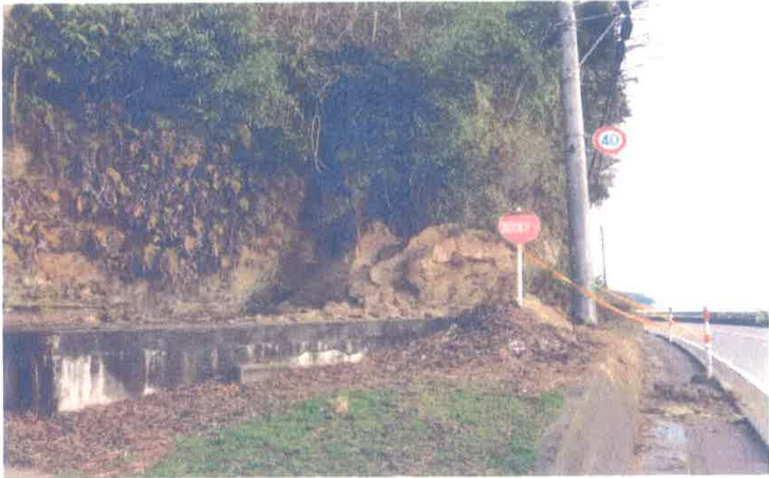
防火用水付近の落石破損状況（平成 28 年 2 月 26 日撮影）
