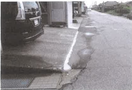
1) 前より窪9号線海側を見る。 側溝無いので水溜りができる。
