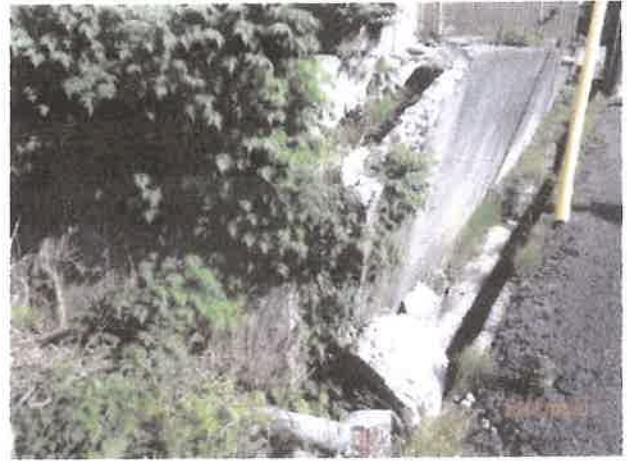
擁壁が反っている。
