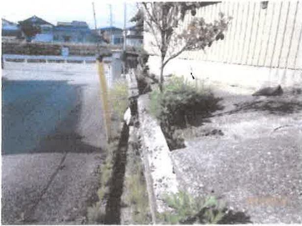
奥の擁壁が崩れそうになっている。
