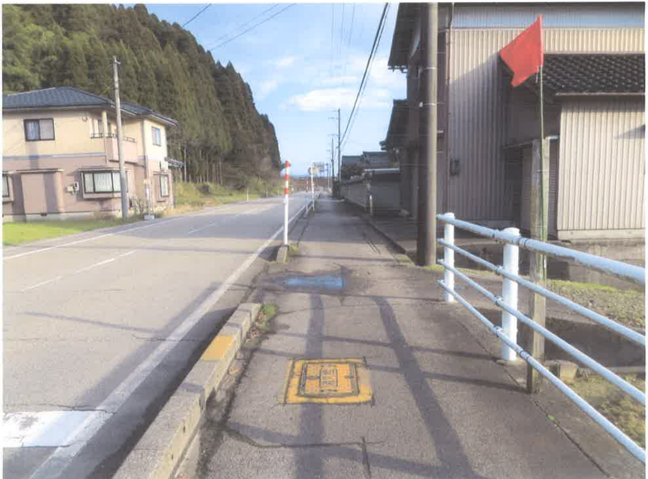
消火栓 (農免道路：七分一交差点)
