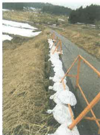
９月再度崩れ土嚢仮処理写真
