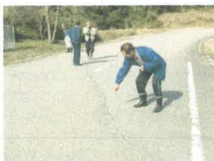
市道一ノ瀬線の亀裂
