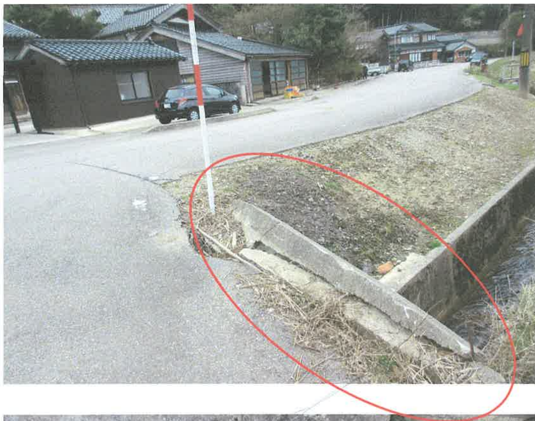
③ 市道 橋欄干破損(除雪車により破損)
