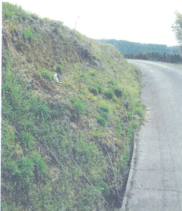
のり面の崩れ (→熊無方面)
