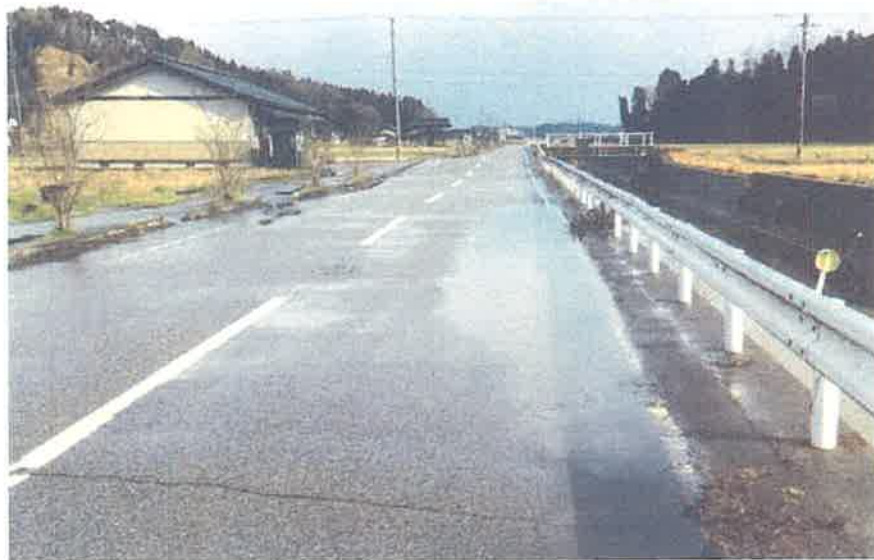
⑧ 車道沈下
