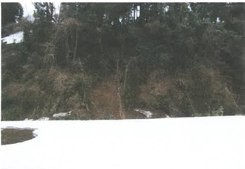
要望事項一② 崩落箇所全景
