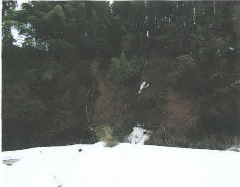
要望事項一② 崩落箇所全景
