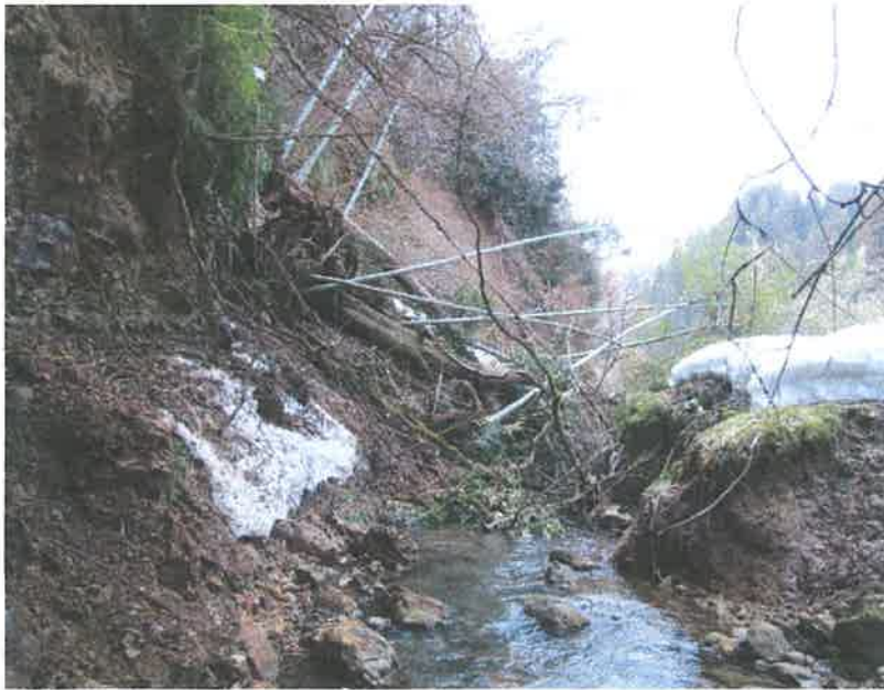
要望事項一② 崩落箇所(下流側)
