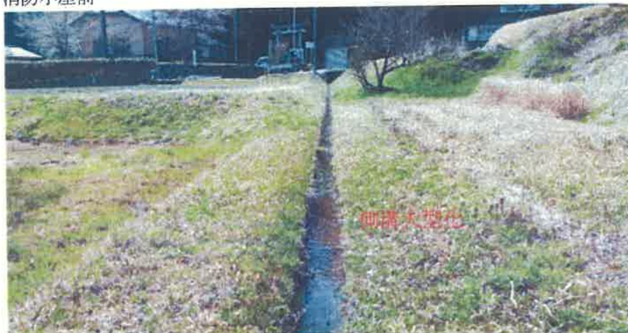
増水時の溢水による浸食部
