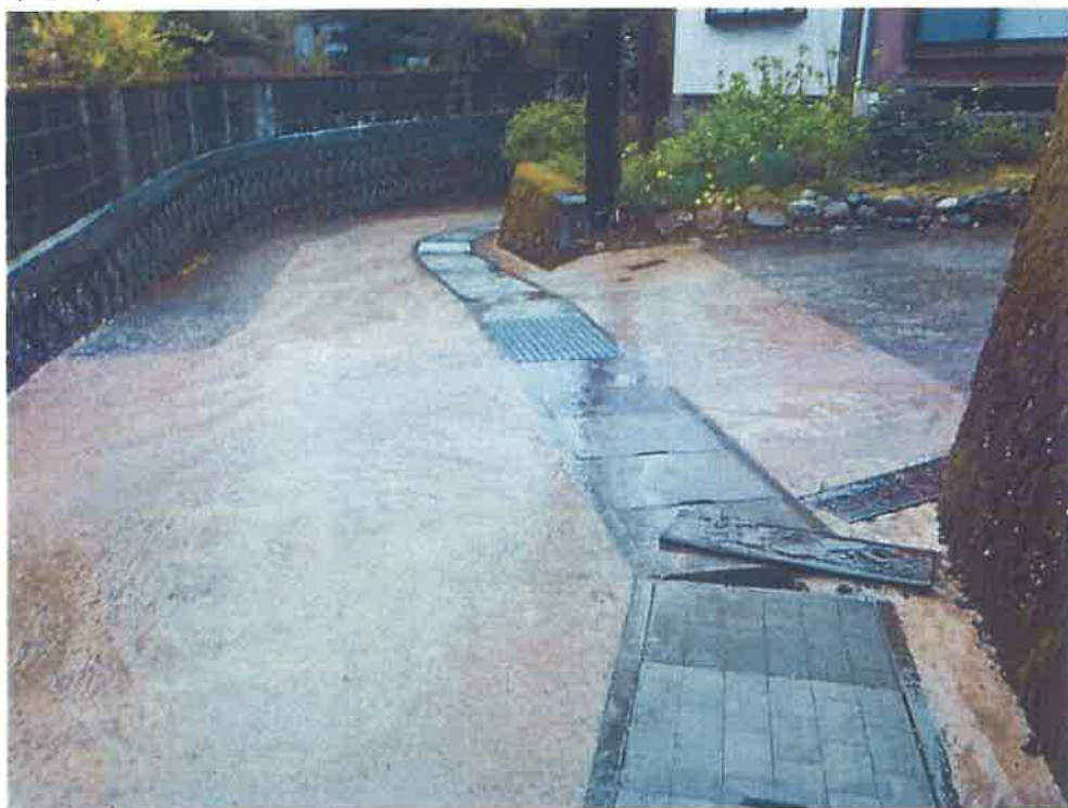
15. 宅前側溝蓋陥没 応急処置として鉄蓋設置
