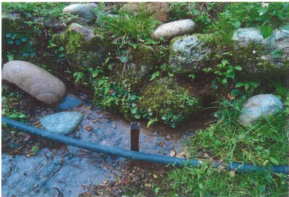
漏水箇所拡大
