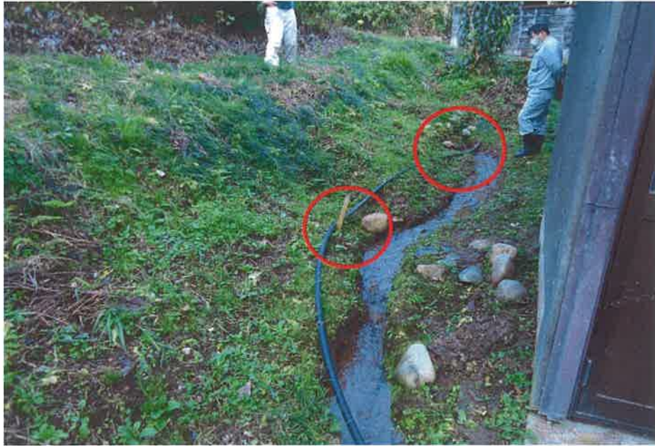
堤体法尻より漏水
