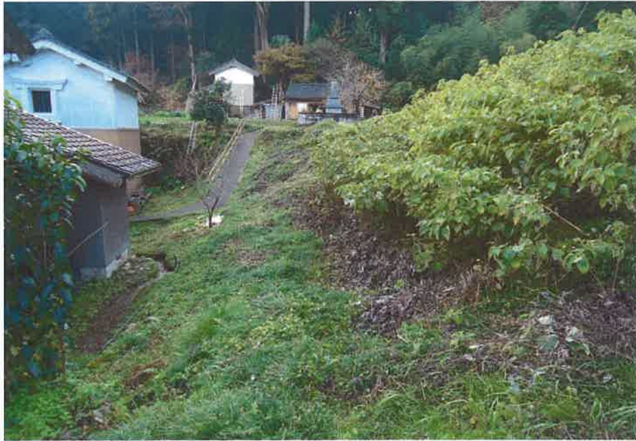
堤体外法面変形状況
