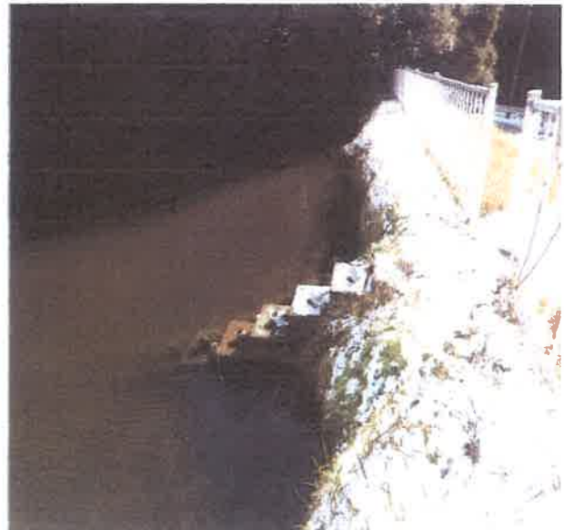
4 老朽斜樋及び堤体上流側法面の浸食
