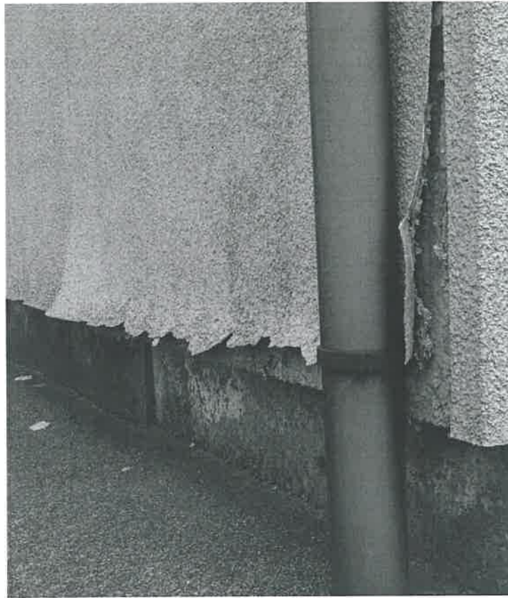
雨どいのところの継ぎ目も壁がめくれ、浮き上がっている。
