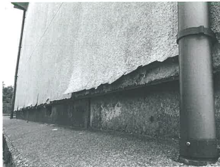
建物の西側に面した壁面。壁と基礎との境目あたりがめくれて崩れている。
