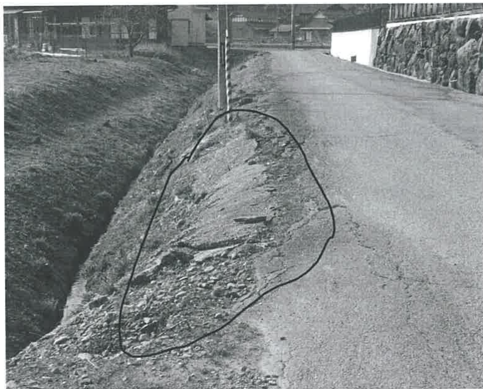
道路の路肩や法面がずれ落ちそうになった状態。放置すると、いずれ用水路を塞いだり、押し流したりすることになる。
