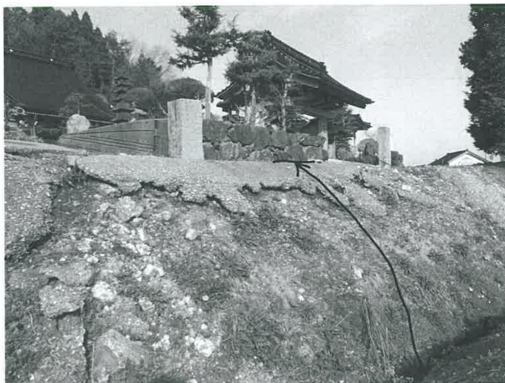
用水路から道路の路面までの高さが2メートル以上。しかも勾配が急なことから高齢者や子どもだけではなく、大人が転落しても危険である。
