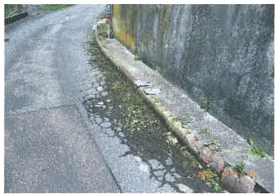
陥没ひび割れ箇所
