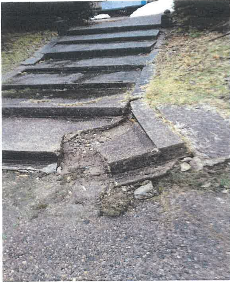
④ 冬期向心損傷
