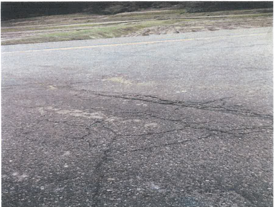
⑥ 道路亀裂
