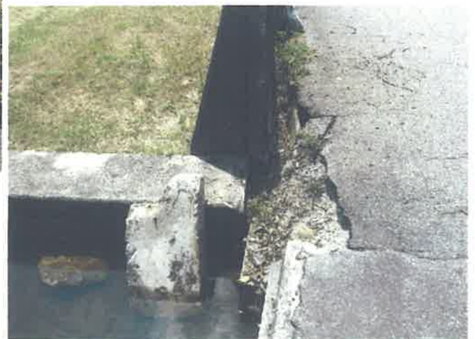
堤防下の排水溝破損で浸食
