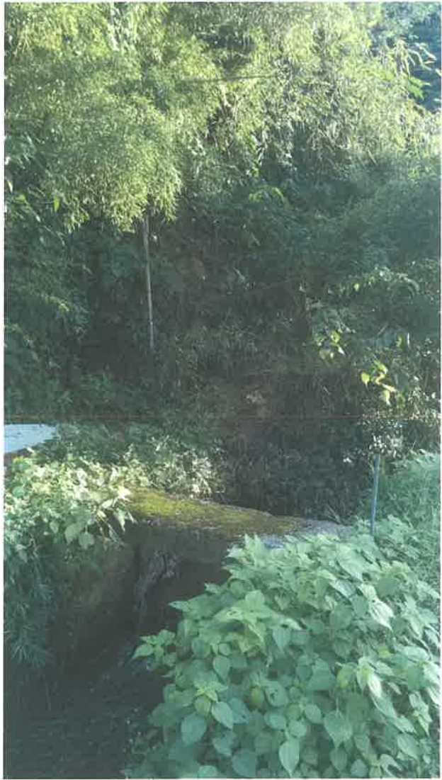
五郎平水門付近の崩壊法面
