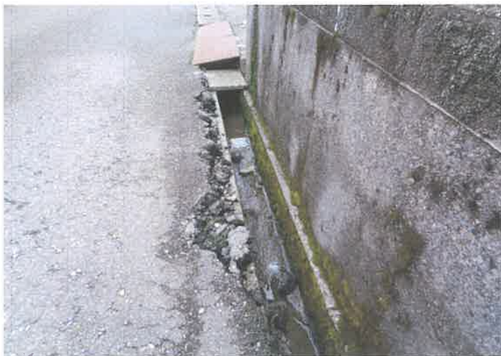
市道路肩の崩れ状況
