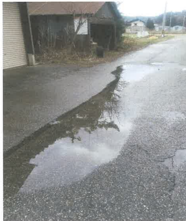
市道凹みによる水溜り状況
