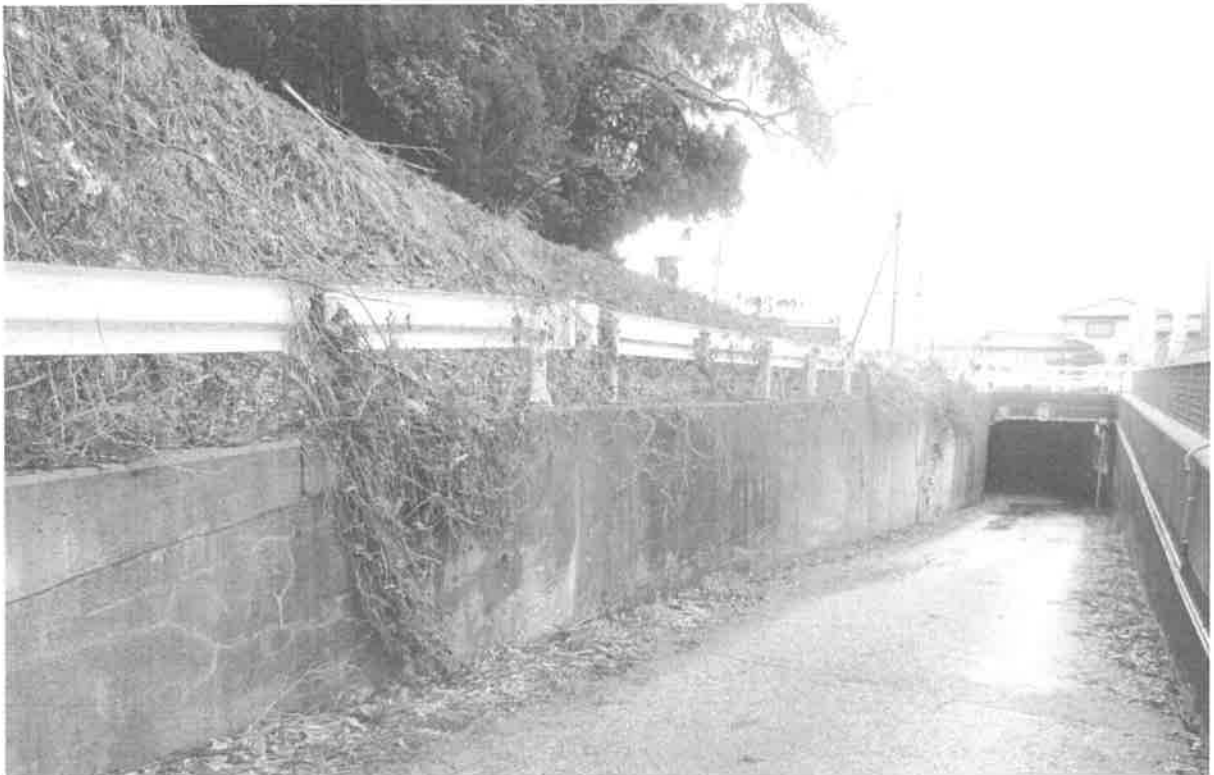
●清水地区から国道160号を経て朝日丘地区へ抜ける地下道。左側には国道から氷見市営村上墓地へ登って行く道路がある。夏にはガードレールを覆いかぶさるように雑草が占領する。(写真は今年1月に撮影)
