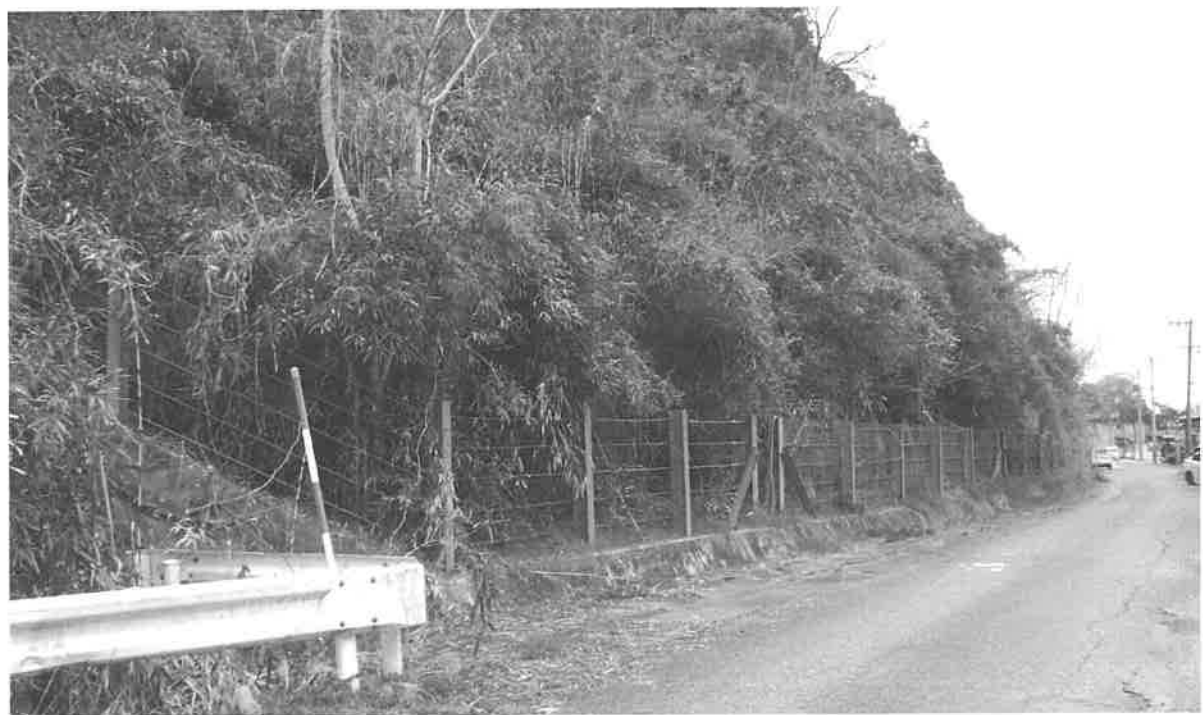
●山ぎわの住宅(空き家)から続く市道沿いの一帯。写真は今年3月に撮影したものであるが、急傾斜地擁壁の法尻は夏になると鬱蒼と樹木・雑草が生い茂り、市道に覆いかぶさるようになる。この先には国道160号の下を抜ける地下道が通っている。また、雑草が繁茂する擁壁上部には氷見市営の村上墓地があり、昨年10月にクマがその墓地の道路から氷見市民舞伝承館脇の国道へ下りたのが目撃されている。
