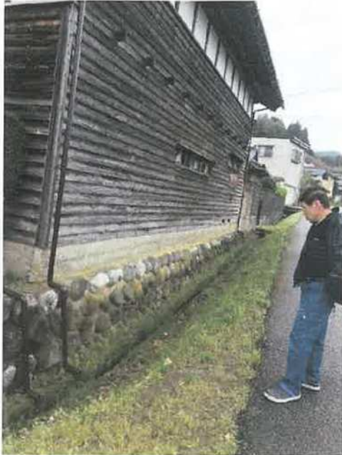
道路崩壊 市道小窪1号線
