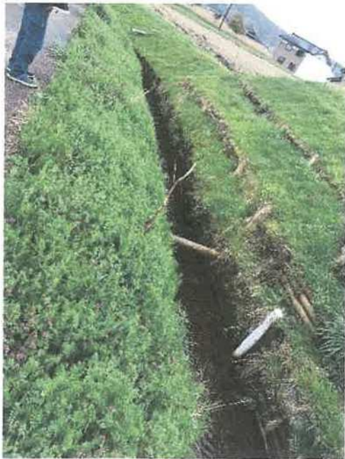
水路側面崩れ
