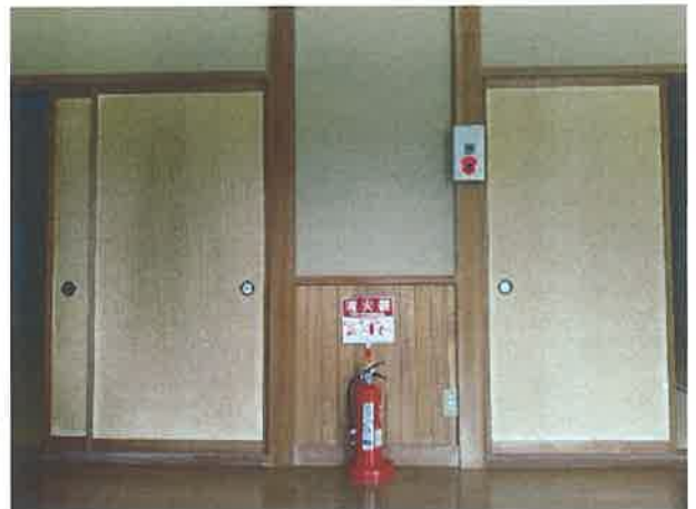
非常用警報装置・消火器
