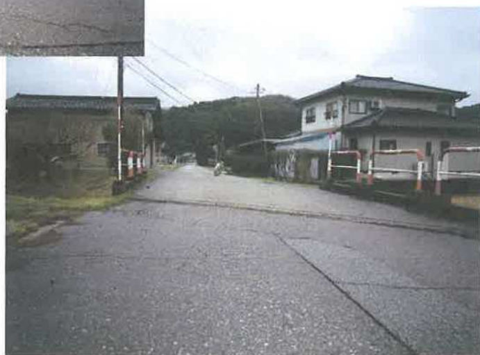
⑥西念寺方面坂陥没 長さ約12m 亀裂約30mm
