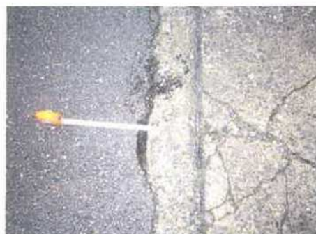
④親田川橋陥没 深さ約20cm 表面亀裂30mm
