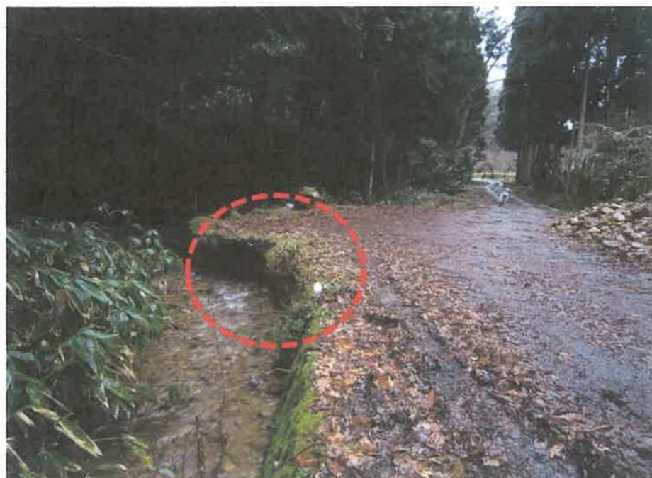
⑧森寺城址方面線路肩崩落 長さ約8m、深さ約1.5m
