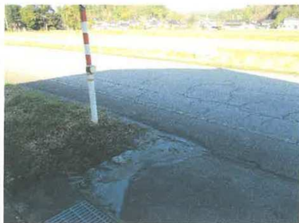
地震時噴射水 埋設国営パイプ破損？
