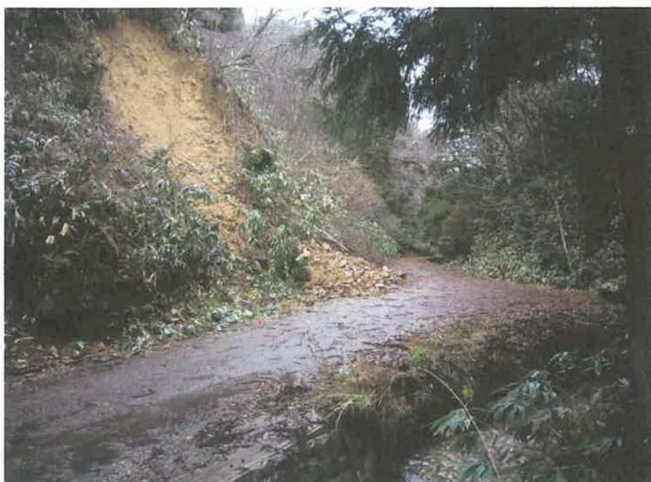
⑦森寺城址方面線法面崩落 幅約10m、高さ約8m
