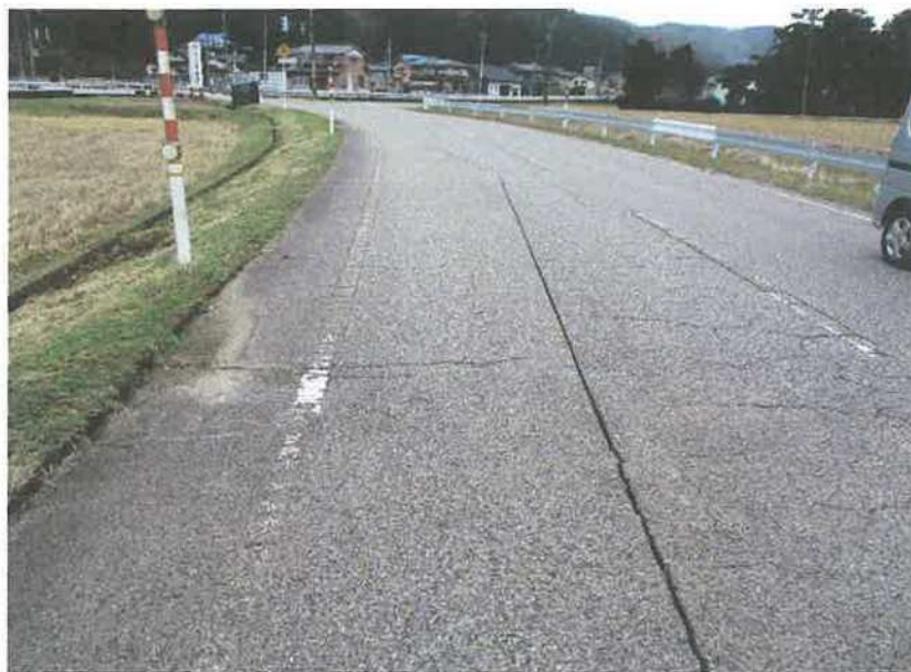
②広域農道 亀裂・沈下約150m
