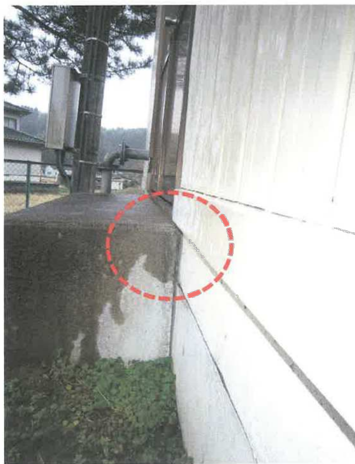
②ポンプ場階段陥没 亀裂20mm
