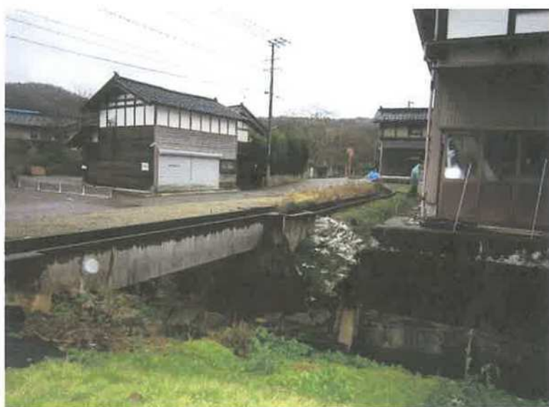
③森寺用水親田川水路橋欠損 取付ボックス欠損漏水 水路橋側面亀裂より漏水 水路幅600mm
