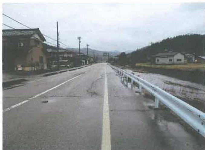
①農道交差点付近亀裂・段差
