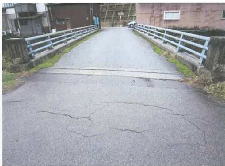
①向出橋段差
