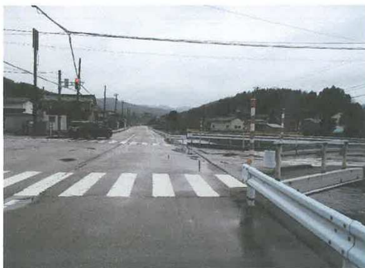
③広域農道森寺橋段差約30mm
