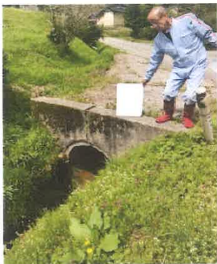
① 地震による損壊
