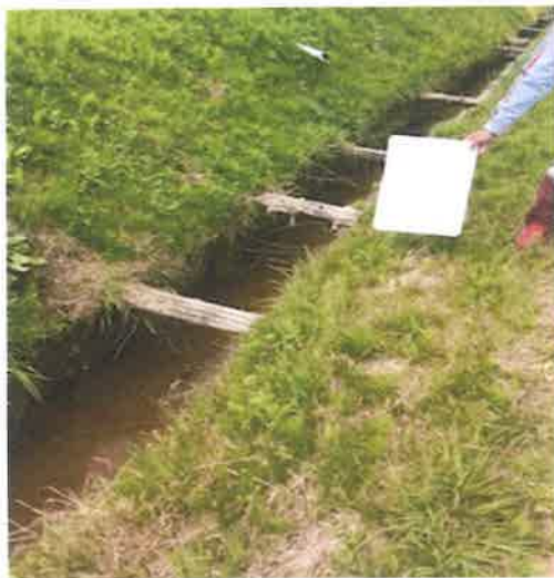
⑤土圧でL字溝の損壊が進行。
