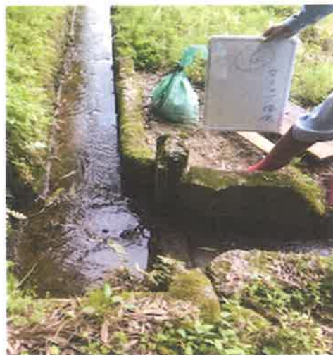
⑥タメマス損壊し民有地に川水流入する。
