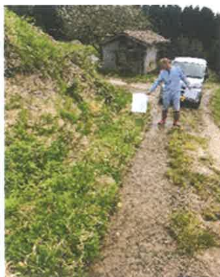
⑧U字溝が埋まり下流に水が流れない。
