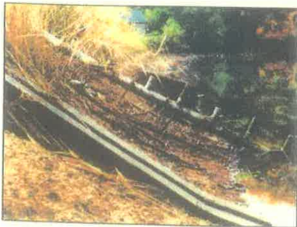
斜樋の老朽化
